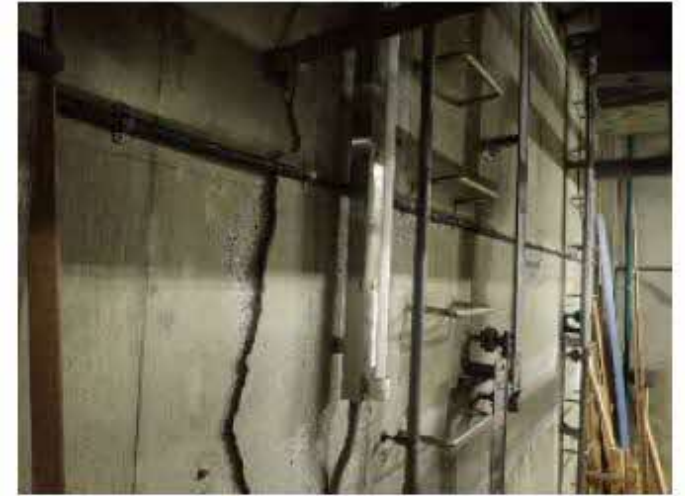
【写真 13】 受水槽外壁のひび割れ
