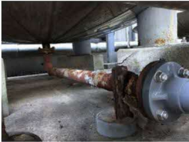
【写真 11】 隠蔽部の配管の腐食
