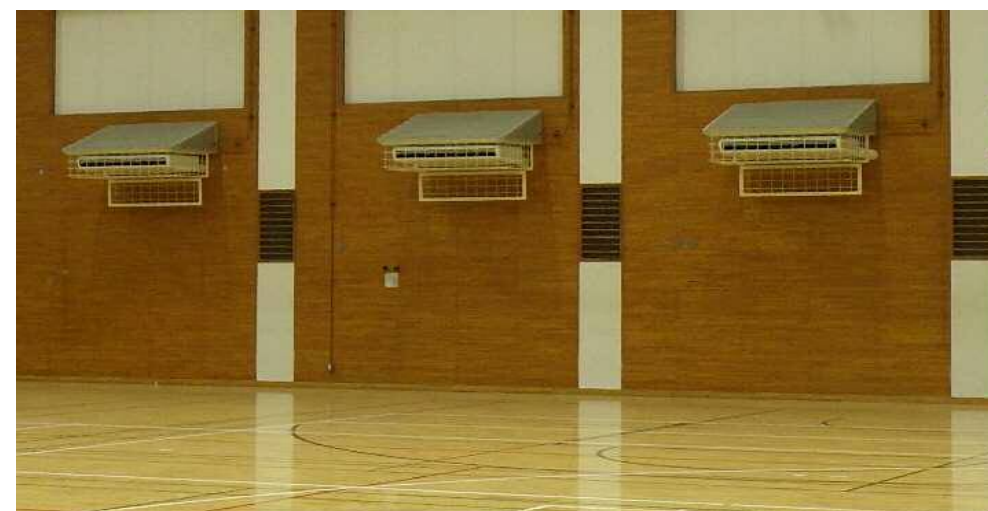
リースおよび工事による空調設備設置例
