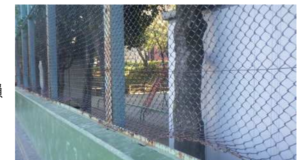
フェンスの破損状況
