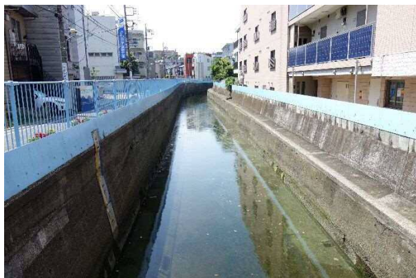
溢水防止板設置状況
