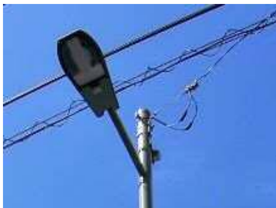
災害時消えない街路灯
