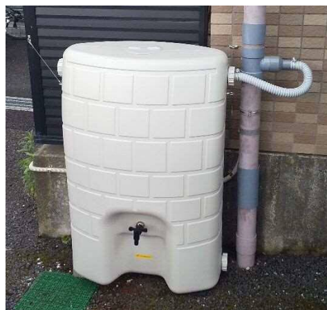
タンク設置例
