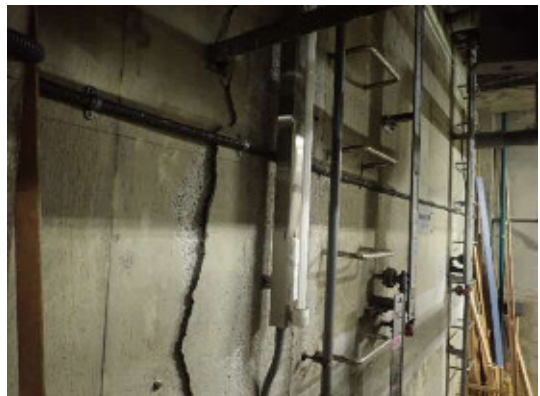
[写真 13] 受水槽外壁のひび割れ
