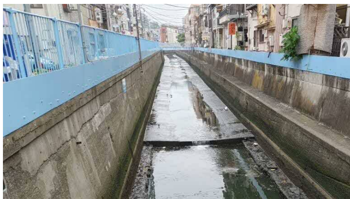
溢水防止板設置状況
