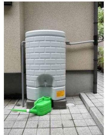
タンク設置例
